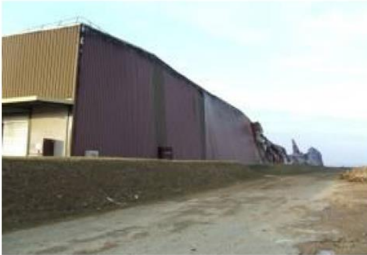
a) Bâtiment endommagé après le feu
