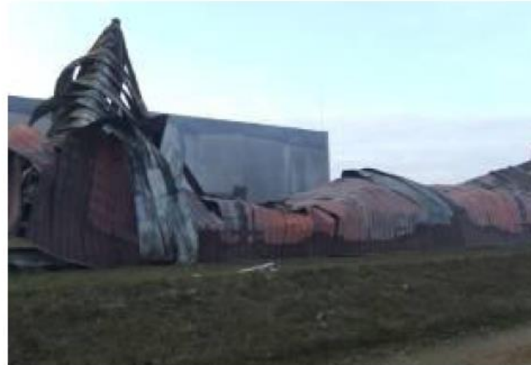
b) Ruine de la structure vers l'intérieur
