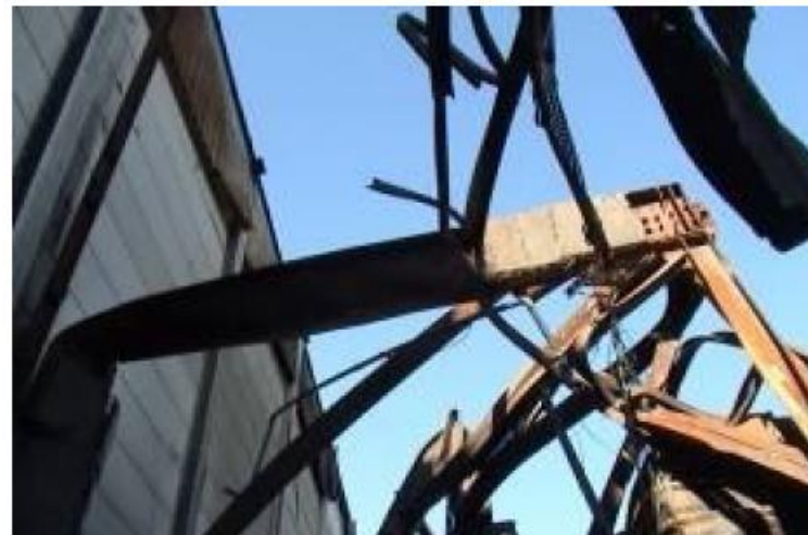
d) Composantes de la structure après le feu
